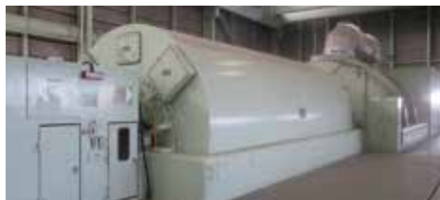
4号タービン発電機
