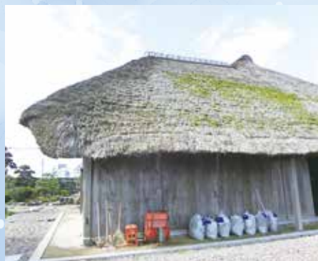
劣化が進んだ東側屋根
