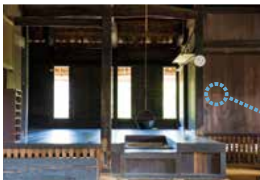
東日本大震災時の津波による浸水の高さを示す。壁にうっすらと水の跡が残っている。土壁は削られ建具は流されたが建物は耐え残った。
