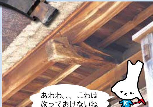
割れてしまった梁
