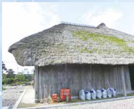
劣化が進んだ東側屋根
