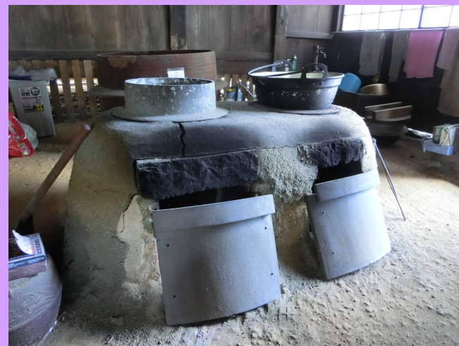
工事前、劣化が激しく ヒビ割れてしまっていたかまど
