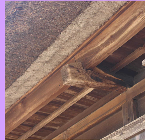
工事前 割れてしまっていた梁
