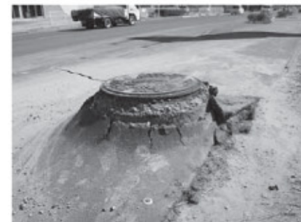
液状化で隆起した下水道のマンホール
