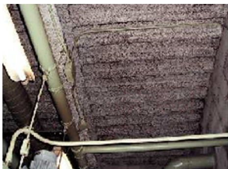
石綿含有吹付けロックウール
