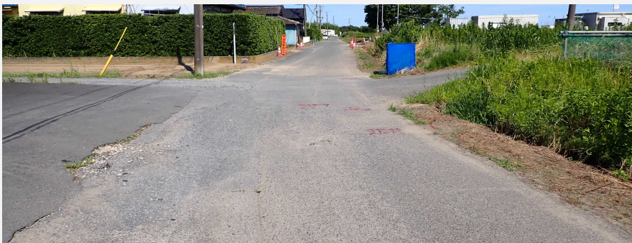
施工前 大雨等の際、常陸川の水位上昇によって道路の冠水が起こる状態。
