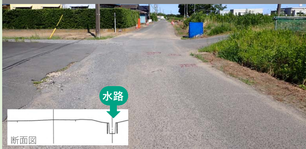
水路が片側にしかなく、排水能力が不足
