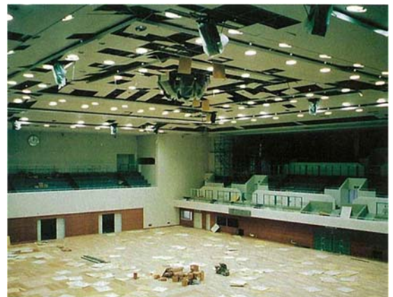
図 天井の脱落状況イメージ
