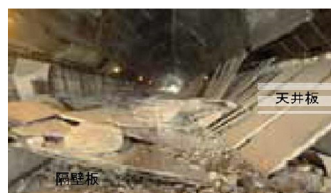
写真-4 天井板崩落状況②
