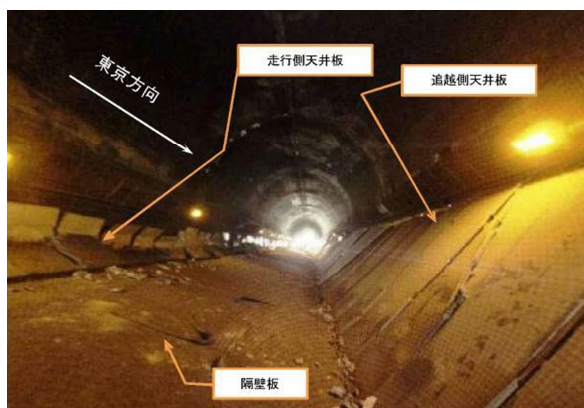
写真-3 天井板崩落状況①
