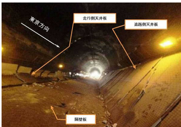
写真-3 天井板崩落状況①
