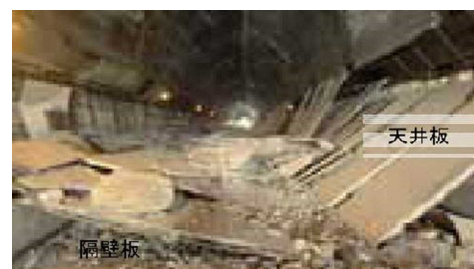
写真-4 天井板崩落状況②
