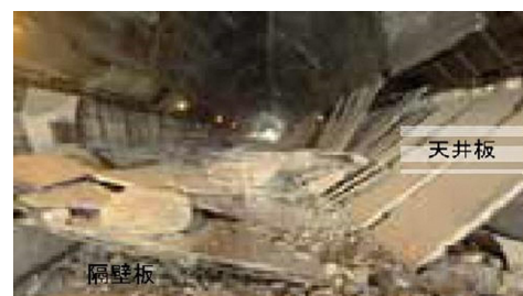
写真-4 天井板崩落状況②
