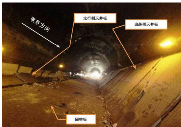
写真-3 天井板崩落状況①
