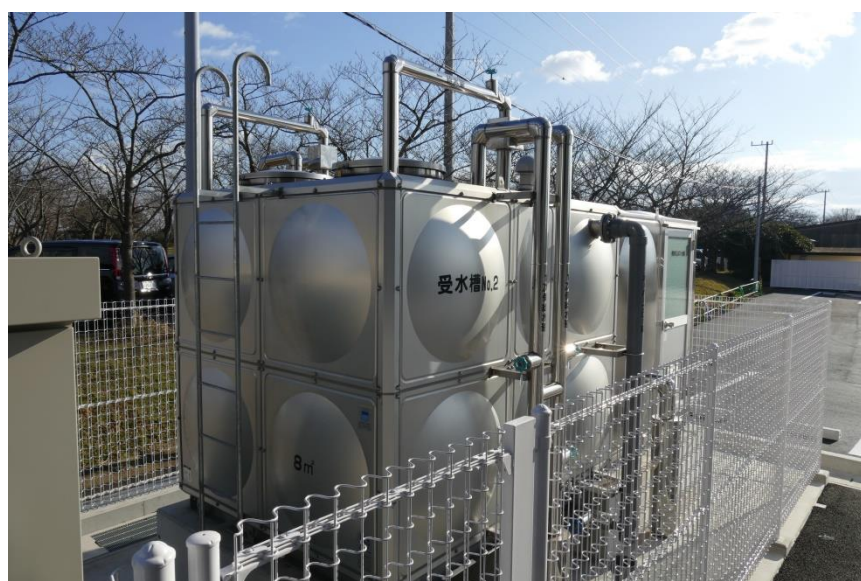
図 5 - 1. 貯水槽水道（受水槽）
