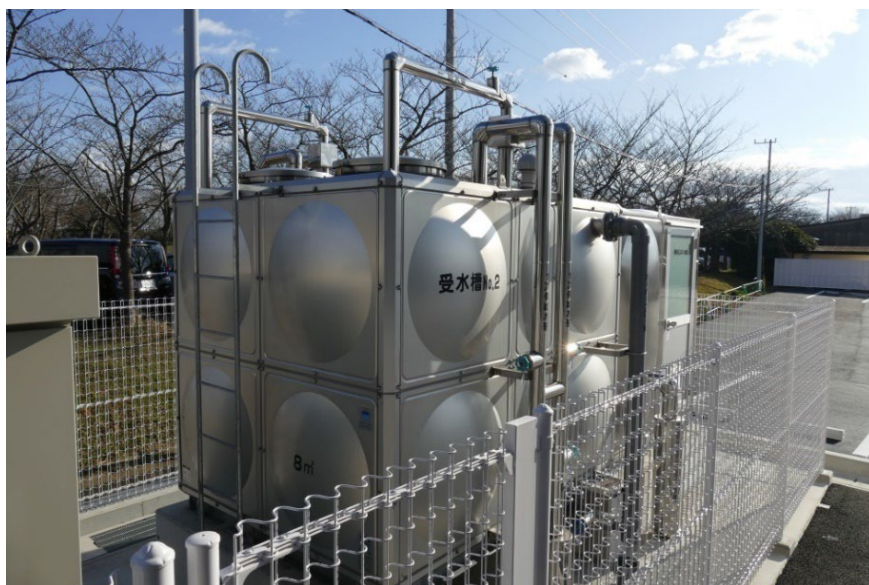
図5-6. 貯水槽水道（受水槽）
