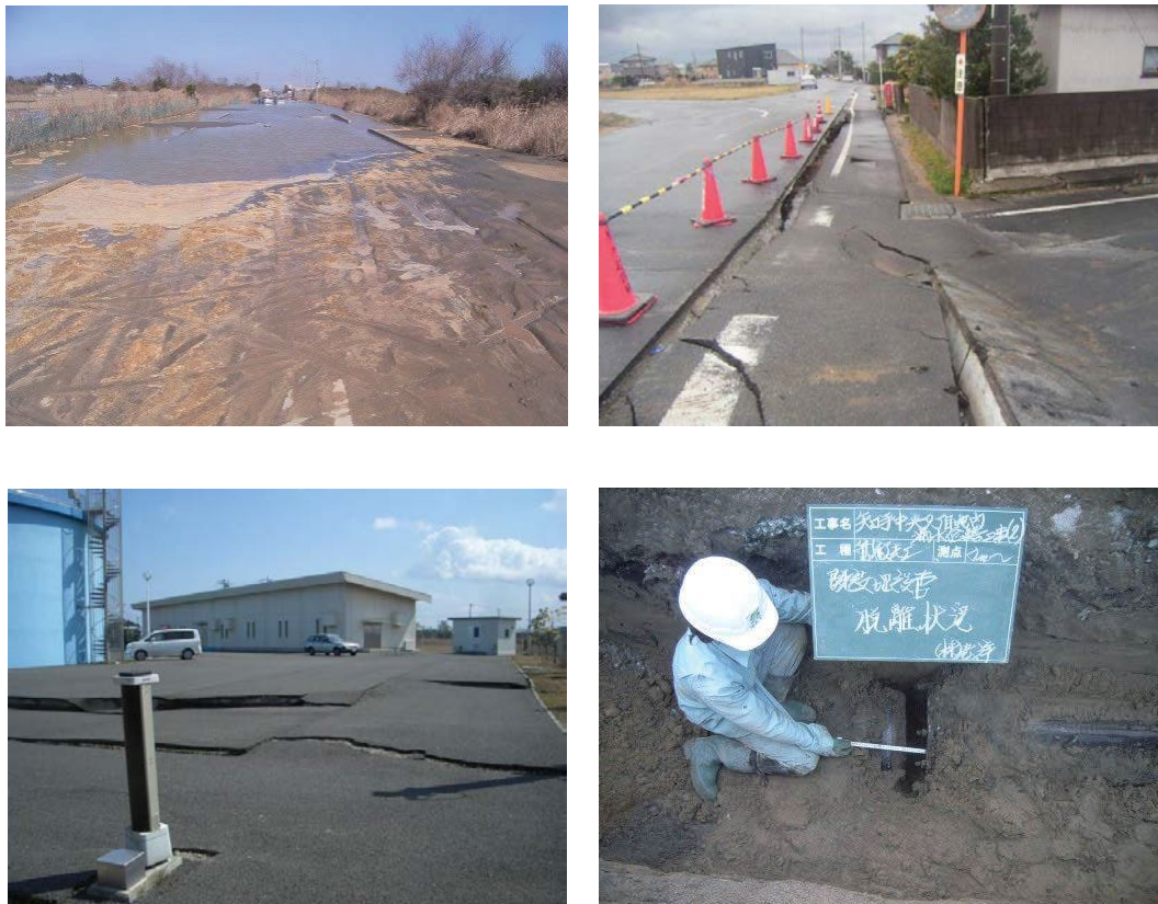
図5-17. 神栖市の東日本大震災における水道施設の被害状況
