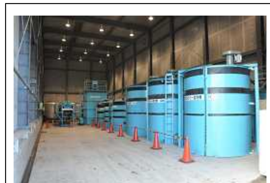
地下水処理設備の全景(北側より撮影)
