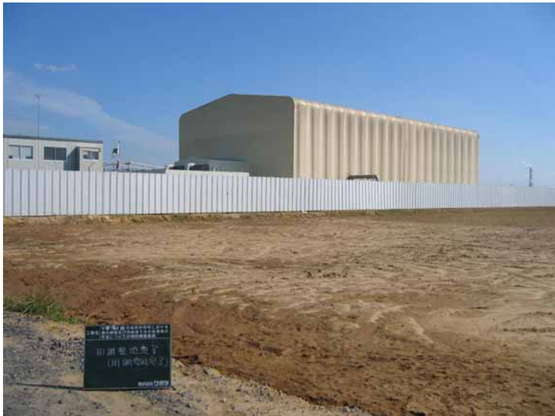
復旧作業終了後の汚染地下水処理プラント設置場所
