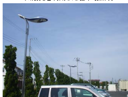
「第三学校給食共同調理場」での 太陽光を利用した駐車場照明
