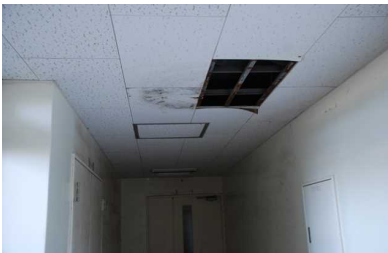
管理施設天井の劣化
