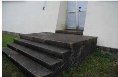
入口階段の劣化
