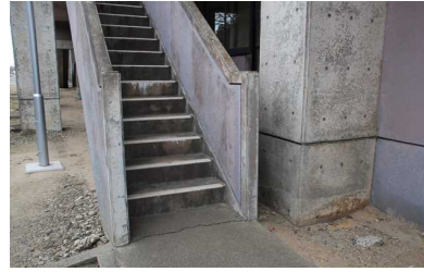
外階段の劣化など
