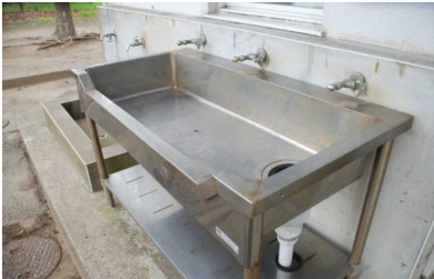
給水設備の劣化
