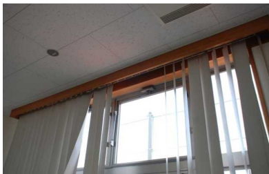
管理棟カーテン(ブラインド)の破損
