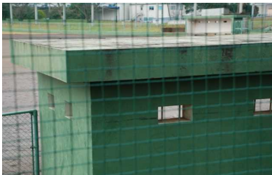
控席ベンチの外壁の劣化
