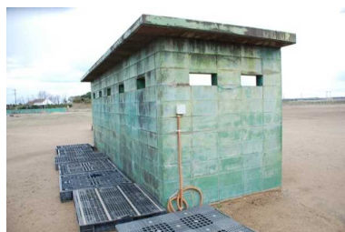
控えベンチ外壁の劣化
