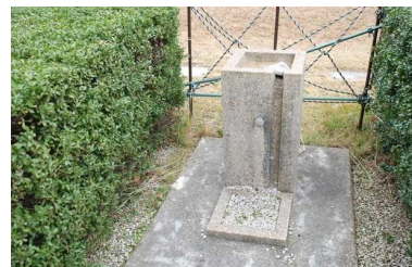
弓道場給水設備の破損
