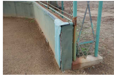
バックネットの劣化
