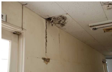
管理施設天井の劣化
