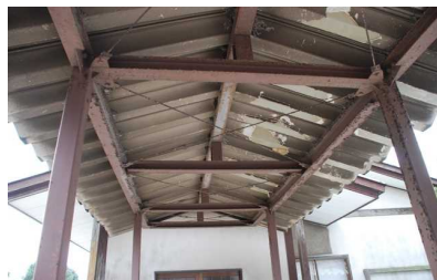
弓道場通路の劣化など
