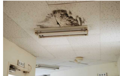
管理施設天井の劣化
