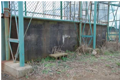
バックネットの劣化
