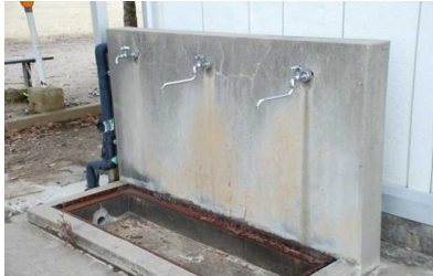
給水設備の劣化
