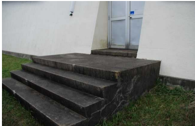
入口階段の劣化
