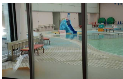
プールタイルの劣化
