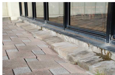
外構部の劣化
