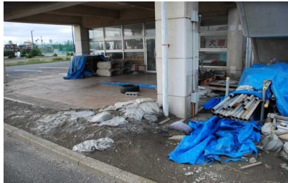
裏入口外構部の劣化
