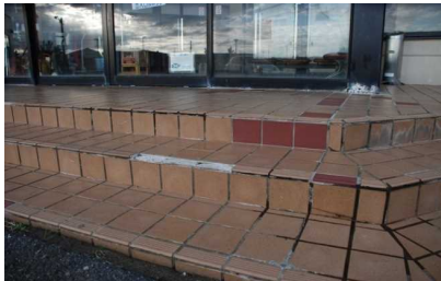
正面玄関階段の劣化
