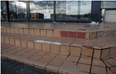
正面玄関階段の劣化
