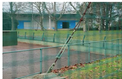
ネットの劣化
