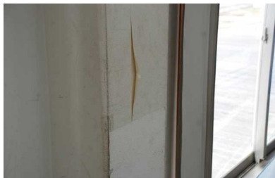
管理棟壁面の劣化
