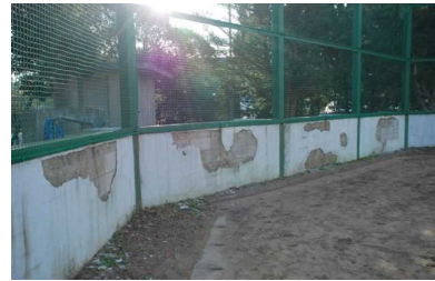
バックネットの劣化
