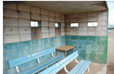
控えベンチの劣化
