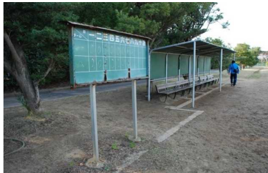
スコアボードの劣化
