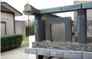
外壁の劣化など
