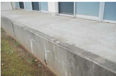
建物外構部の劣化
