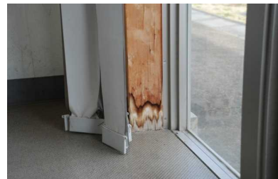
管理棟の雨漏り
