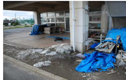
裏入口外構部の劣化
