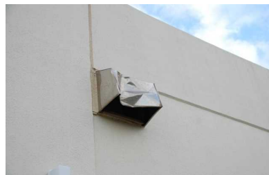
排気設備の劣化
