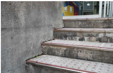
正面玄関階段の劣化
