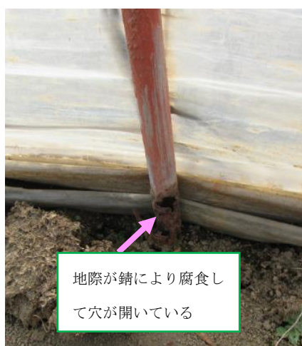
写真1 脚部の腐食状況
