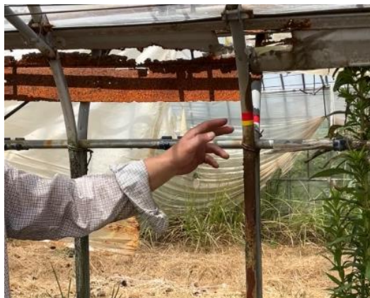
写真1 谷部の雨樋部分の腐食
