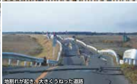
地割れが起き、大きくうねった道路
