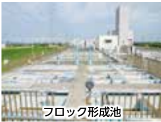
フロック形成池 汚れの塊(フロック)を作る
