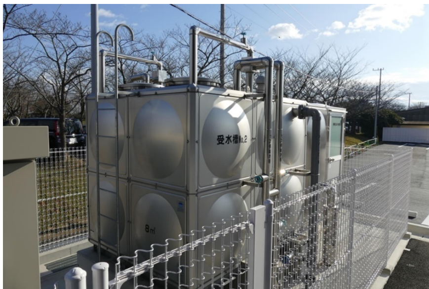
図 5 - 6. 貯水槽水道（受水槽）
