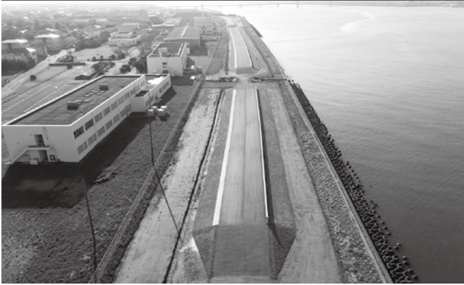
この箇所は、堤防用地の幅が少ないため、コンクリート擁壁と土で堤防が作られています。
