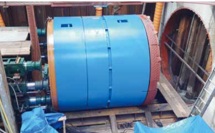
鹿島港に雨水を放流する「放流渠」整備で、地中を掘り進めた推進機
