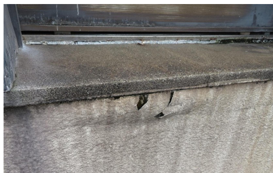
[写真10] 割れた外壁
