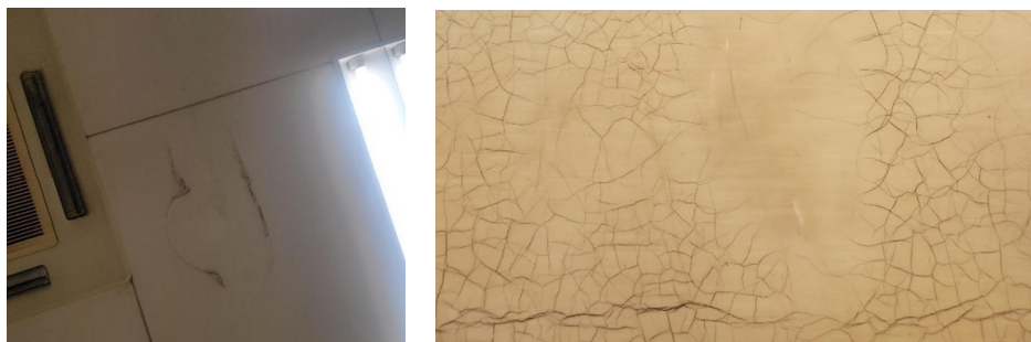
[写真 13] 雨漏りの跡が見られる天井 [写真 14] 2階見学エリア付近の床のひび割れ
