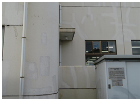
[写真11] 修繕履歴のある外壁
