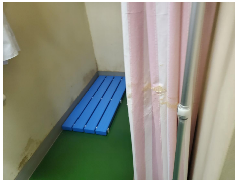
[写真8] カーテンで区切られた簡易な前室
