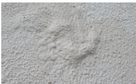
[写真9] 雨水を含んだ外壁
