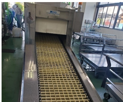
[写真 16] 更新済みの食缶洗浄機
