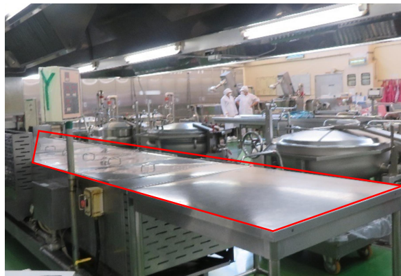
[写真6] 揚物機と釜の距離が近い様子
