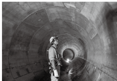
大雨による浸水被害を防ぐ！地中で私たちの生活を守る巨大な雨水管渠
