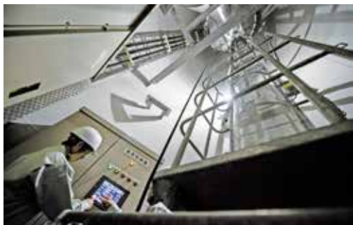
風車のタワー内部
